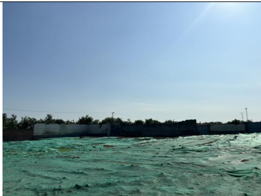
升压站内部图
